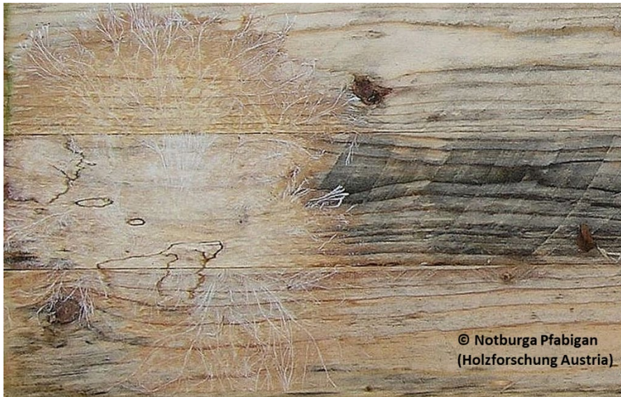
Abb. 5.4.17: Praxisbeispiel, bei dem zuerst nur Schimmel- und Bläuepilze vorhanden waren. Der Holzfäulepilz (weißes Myzel) breitet sich erst später aus, verdrängt dann gut erkennbar die anderen Pilze.
