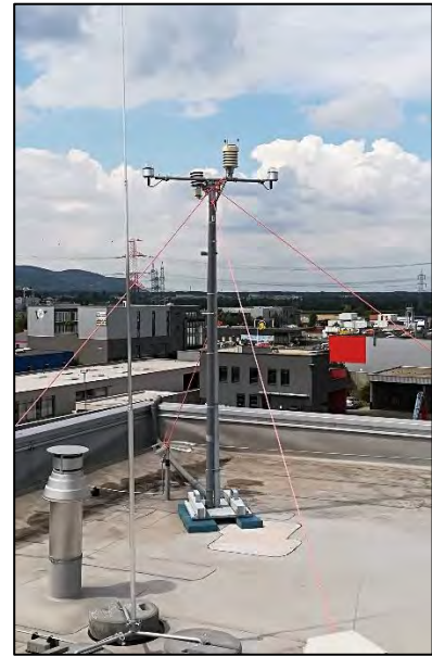
Abbildung 14: Wetterstation am Dach des ACA in Stetten
