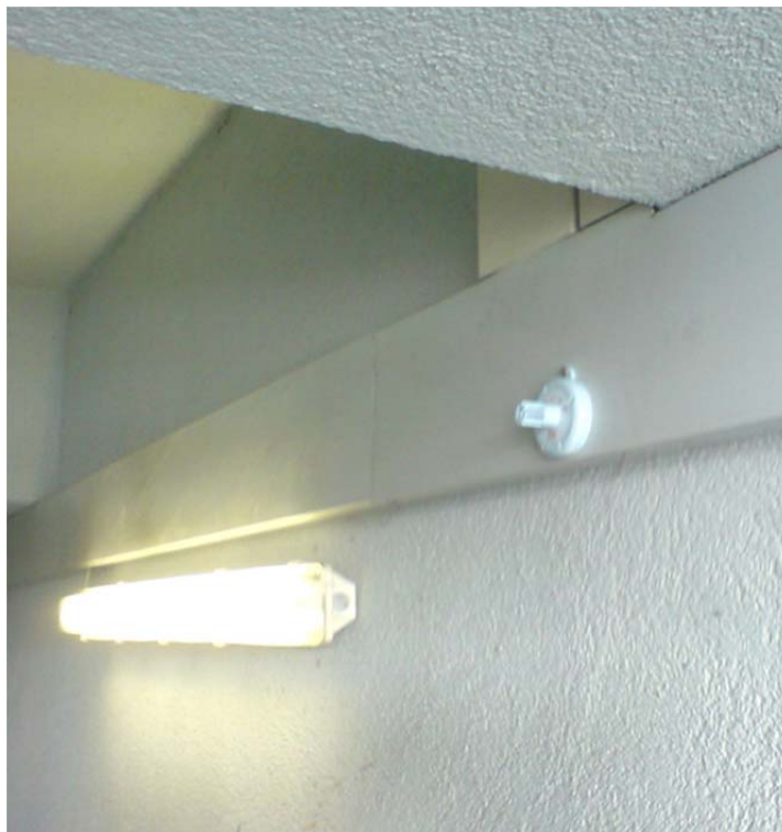
Bild 403: Darstellung des Messfühlers, der sich in der Mitte der Rampe in der Tiefgarage 1 befindet.
