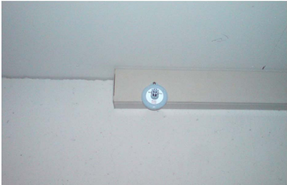
Bild 404: Darstellung des Messfühlers, der sich direkt in der Tiefgarage 1 befindet.
