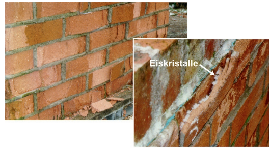
Bild 16. Schalenbildung an einem berechneten Vollziegel-mauerwerk, bei dem sich in der kritischen Zone sichtbar Eiskristalle bilden, die zu einer Zerstörung der Materialfestigkeit in diesem Bereich führen
