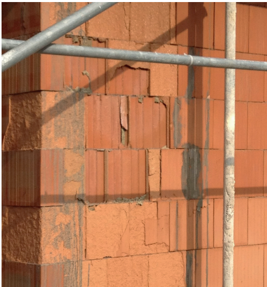
Bild 13. Frostbedingte Abplatzungen an nassem Ziegelmauerwerk während der Bauphase
