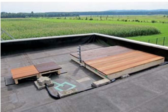
Abb. 3: Versuchsaufbau zur Messung der Dachtemperaturen unter einem Dachterrassenaufbau (Holzarten: Bankirai und Esche dunkelbraun keseldruckimprägniert. Messungen an der Holzunterseite und der Dachoberfläche sowie im darunter liegenden Innenraum.
