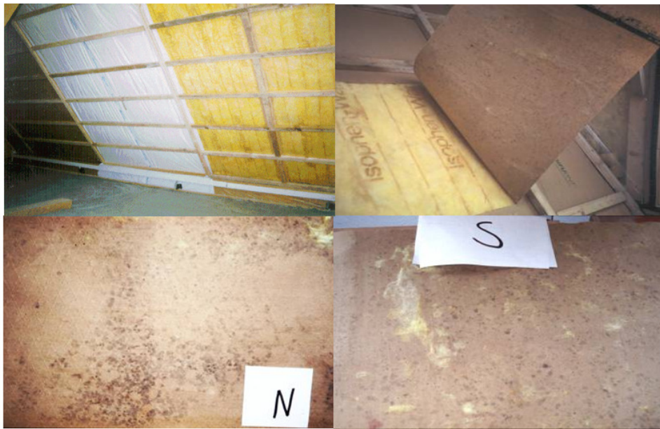
Bild 10: Innenansicht und Schimmelpilzbildung auf der Rückseite der Dampfbremspappe bei Nord- und Südorientierung eines steil geneigten Blechdachs infolge austrocknender Schalungsfeuchte.
