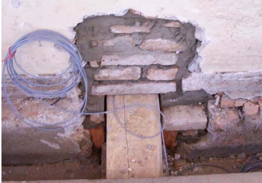
Abb. 57 Einbausituation der Variante S11/4. Hier erfolgte eine besonders großzügige Mauerwerksöffnung mit dementsprechend üppiger Ausmauerung unter Verwendung größerer Mengen feuchten Mörtels.
