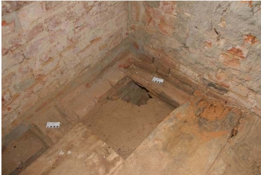
Abb. 4 Zerstörter Balkenkopf im Sanitärbereich eines um 1850 errichteten Gebäudes.
