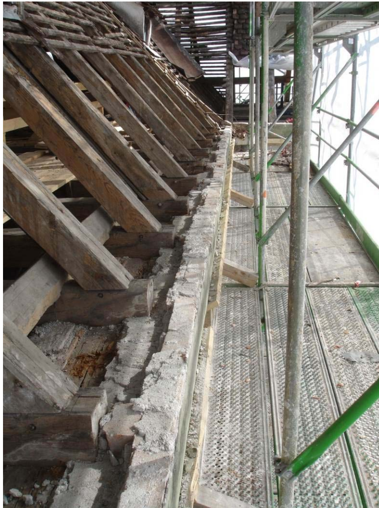
Abb. 39 Ansicht der Balkenköpfe nach Abdeckung des Daches auf der Südseite.
