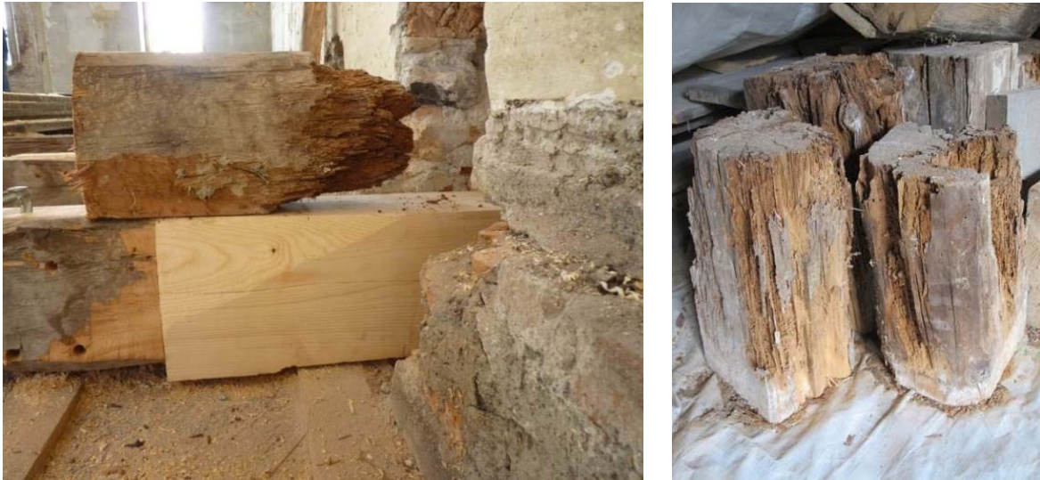
Abb. 22 Ansicht einer ausgeführten Überblattung mit darüber liegendem originalem Holzbalkenkopf (links) und weiterer stark von holzerstörenden Organismen beschädigter Balkenköpfe.
