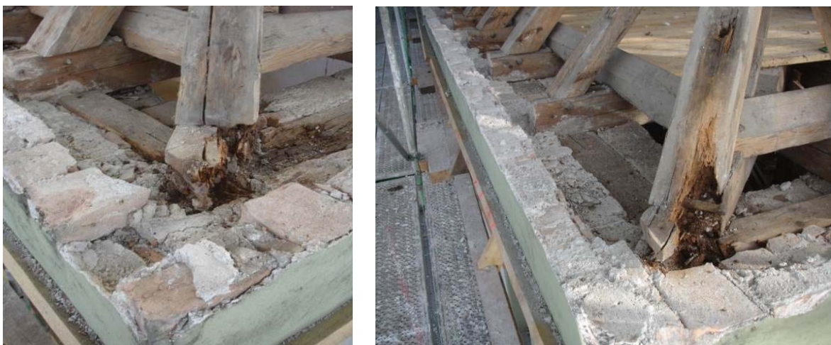
Abb. 41 Ansicht der stark geschädigten Balkenköpfe an der Nordwest- (linkes Bild) und der Südwestaußenecke (rechtes Bild).
