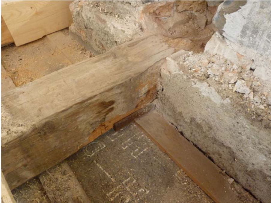
Abb. 23 Ansicht des Holzbalkenkopfes mit altem eingebauten Metallschuh zur statischen Unterstützung der geschädigten Holzbalkenköpfe.
