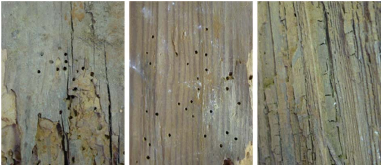
Abb. 93 Käferspuren (Holzwurm, Anobium sp. ), Braunfäule und Schimmelpilze.
