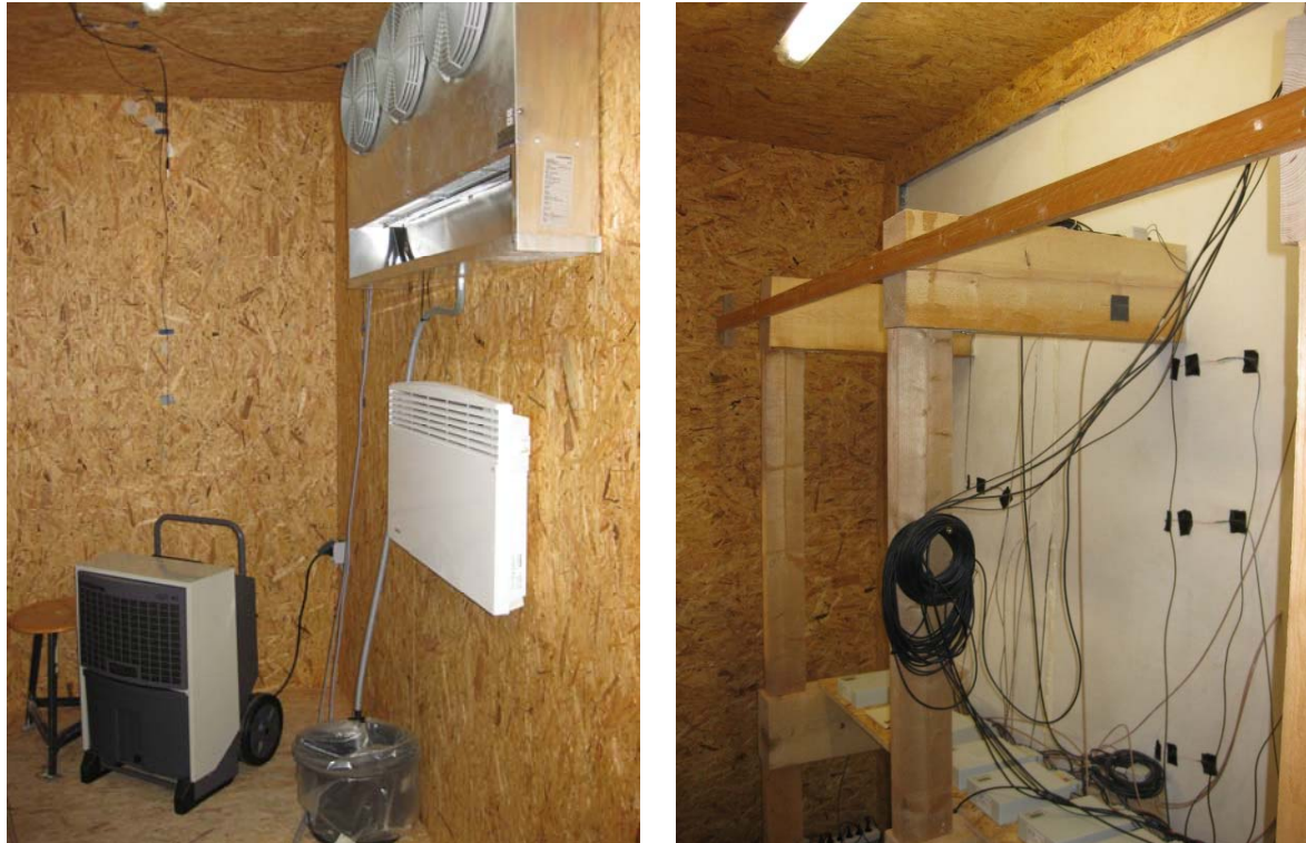
Abb. 103 Blick in die Kaltseite mit verbauter Sensorik und Klimatechnik (links), Blick auf die Warmseite mit den sechs Balkenkopfdetails und der Datenaufzeichnung (rechts).
