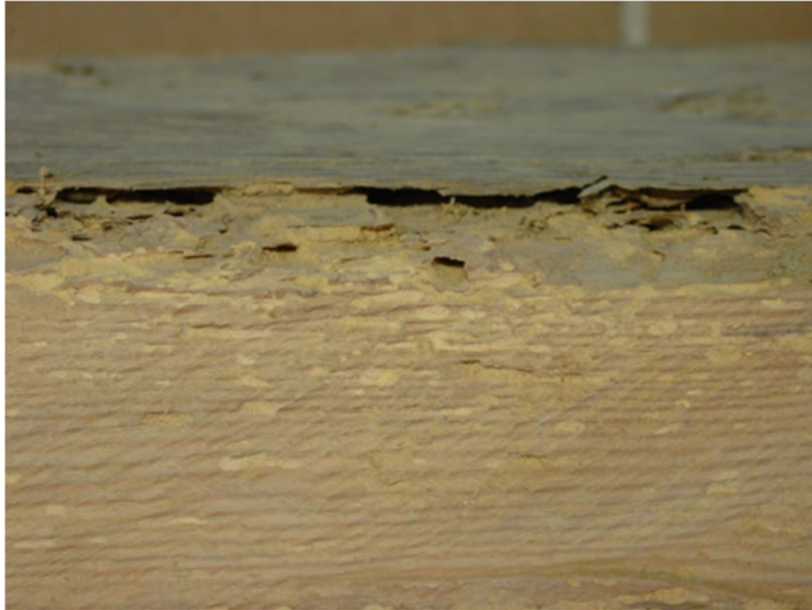
Abb. 92 Befall durch den Hausbock ( Hylotrupes bajulus ).
