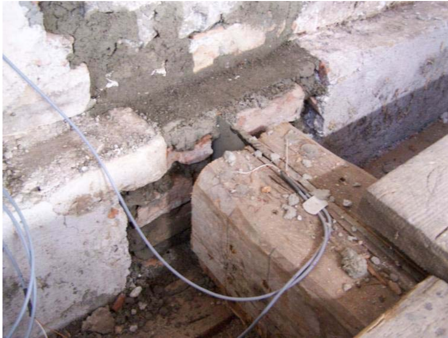
Abb. 30 Ansicht der Sanierungsvariante 2 mit Schlitzblech, aber ohne Dämmung.
