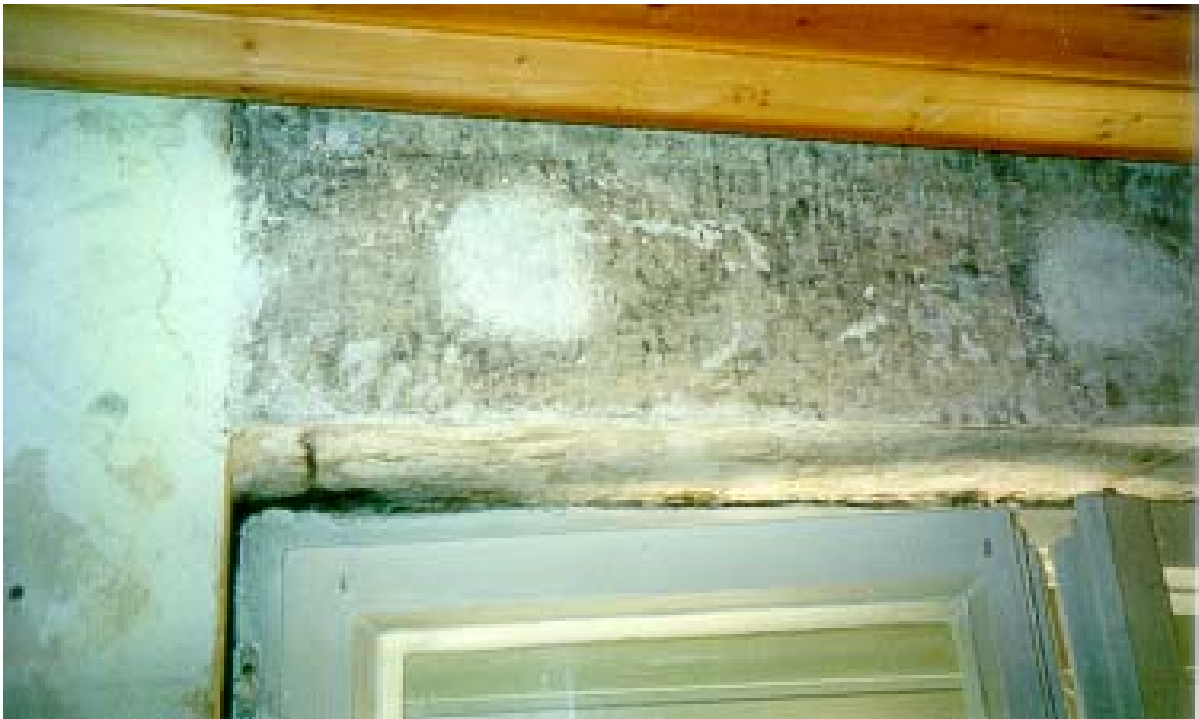
Bild 1: Stockflecken über dem Fenstersturz nach Abnahme einer punktwise verklebten Innendämmung aus gipskartonkaschierten Polystyrol-Hartschaumplatten
