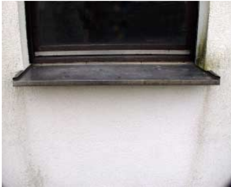
Bild 2: Westwand eines Versuchshauses mit Fensterbrüstung. Aufgrund der zu langsamen Austrocknung von Spritzwasser ist der nach Norden orientierte Bereich der Fensterlaibung (rechts im Bild) veralgt, während der gegenüberliegende, direkt der Sonneneinstrahlung ausgesetzte Bereich keinerlei mikrobielles Wachstum aufweist.
