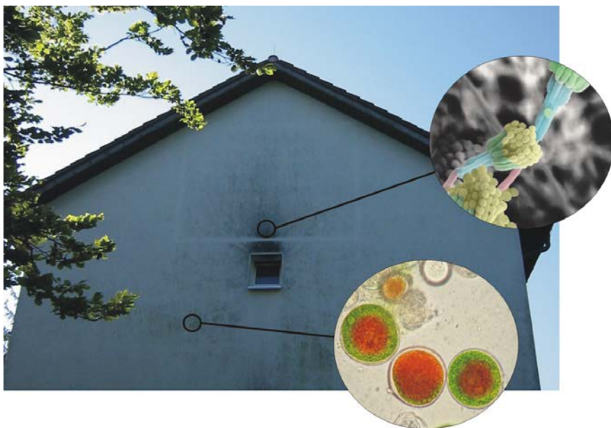
Bild 1: Algenbewuchs einer Fassade mit Wärmedämmverbundsystem und Schimmelpilzbewuchs oberhalb eines Fensters.
