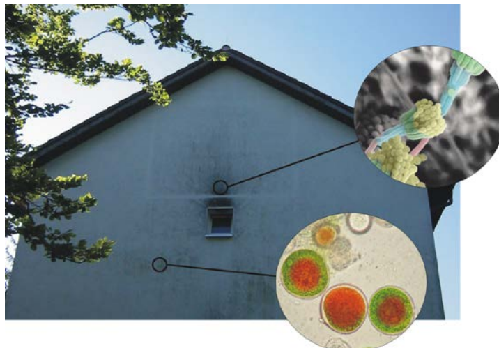
Bild 7 Schimmelpilzbildung oberhalb des Fensters und Algenbewuchs (darunter) an einer mit WDVS gedämmten Fassade.
